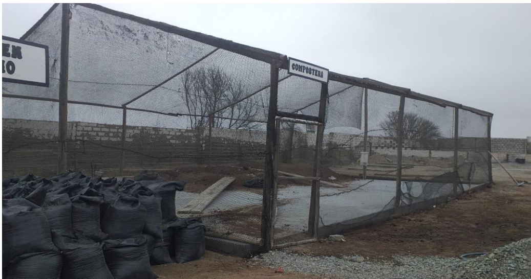
Figura 18. Infraestructura actual de la pre compostera.
