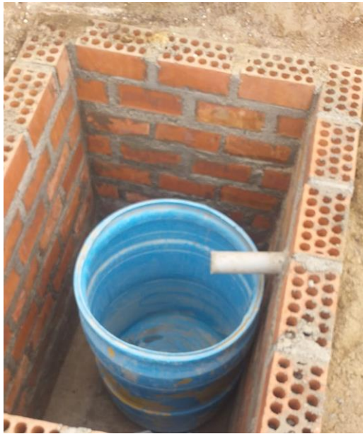
Figura 19. Contenedor para el almacenamiento de lixiviados del pre compost.
