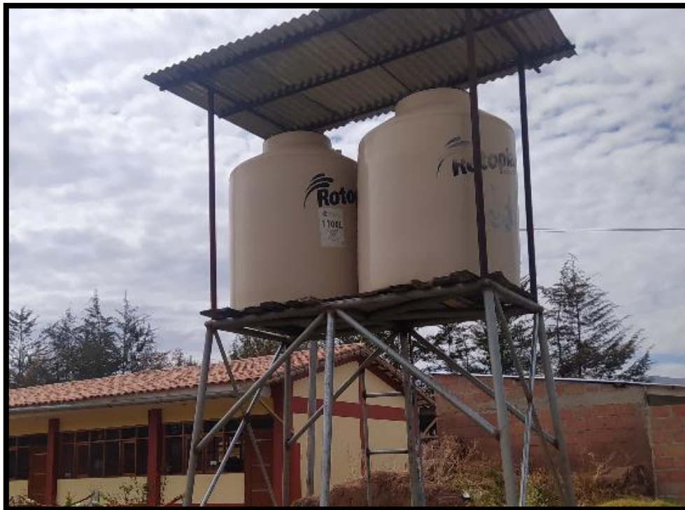
Figura 32: Tanques de almacenamiento que abastecen al baño antiguo y su lavatorio (izquierda) y a la cocina (derecha)
