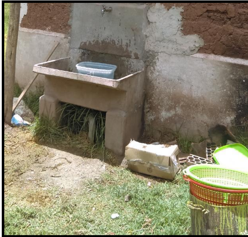
Figura 35: Lavatorio de la cocina para el lavado de utensilios
