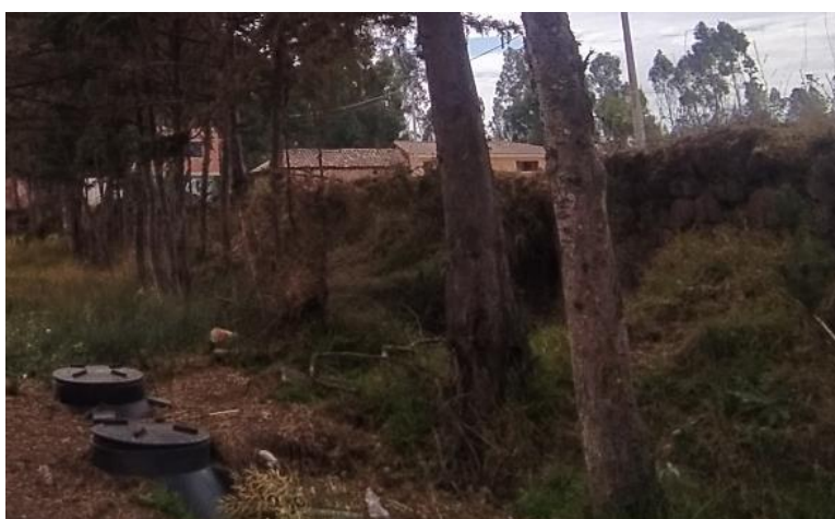
Figura 14: Biodigestores a la salida del baño antiguo muy próximos a la acequia al lado de la Institución Educativa
