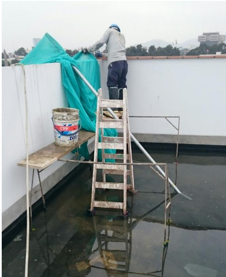
Figura 30. Interferencia por otros trabajos sobre impermeabilización
