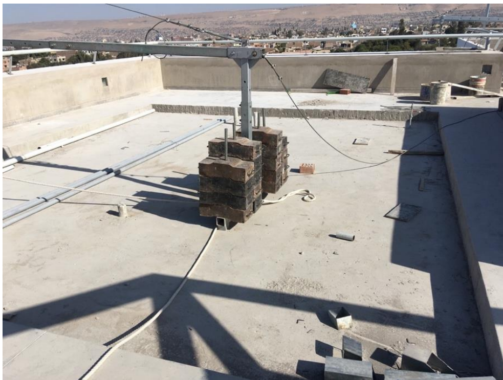
Figura 29. Interferencia por equipos en frente de instalación
