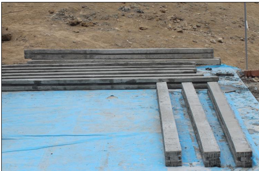
Figura 14: Postes prefabricados de concreto armado
