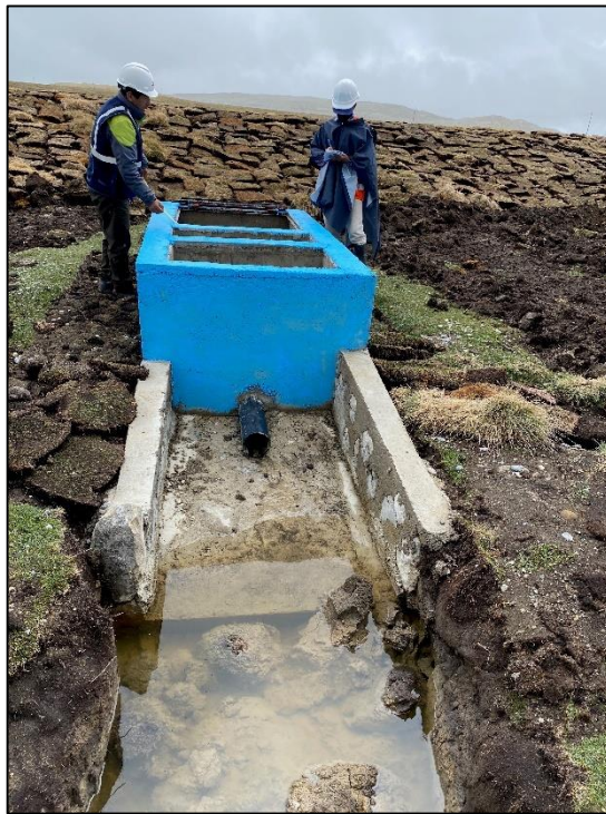
Figura 55: Fotografía de la tubería de descarga instalada en la gocha Ocshagoto (Pas1-2019-Q5)
