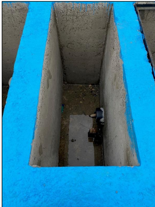
Figura 46: Fotografía de la tubería de descarga instalada en la qocha Uchuy Huascacocha (Pas1-2019-Q4)
