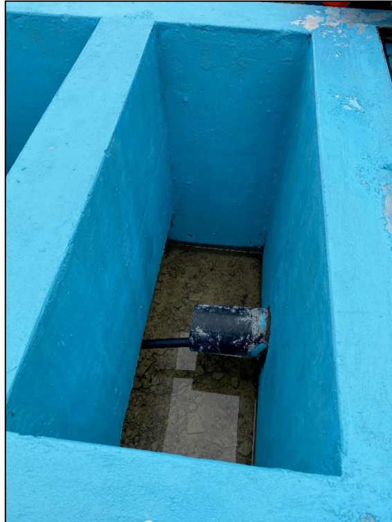
Figura 38: Fotografía de la tubería de descarga instalada en la qocha Llamacocha (Pas1-2019-Q3)
