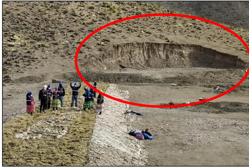
Figura 12: Áreas degradadas por trabajos realizados
