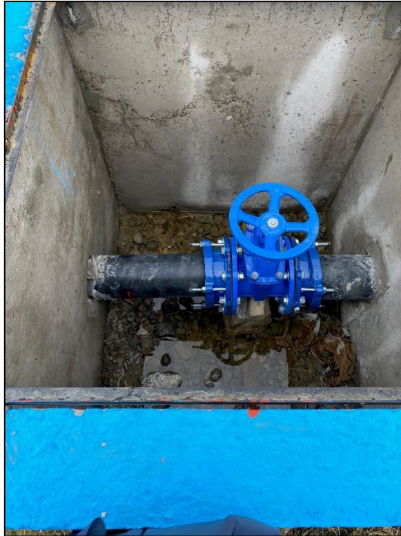
Figura 45: Fotografía de la válvula instalada en la qocha Uchuy Huascacocha (Pas1-2019-Q4)
