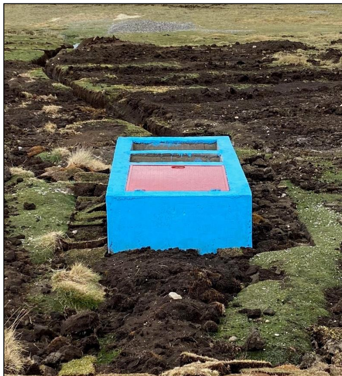
Figura 53: Fotografía de la estructura de la descarga (caja de válvulas) de la qocha Ocshagoto (Pas1-2019-Q5)
