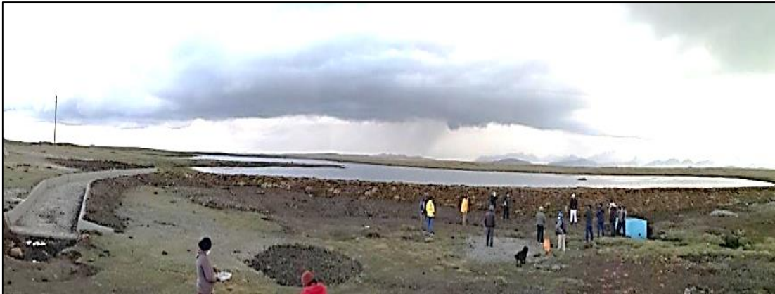
Figura 33: Fotografía del dique construido y obras conexas en la gocha Llamacocha (Pas1-2019-Q3)
