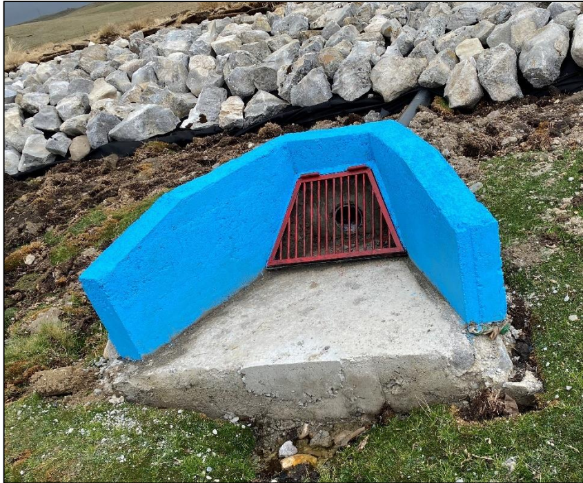
Figura 43: Fotografía de la estructura de la toma (captación) de la qocha Uchuy Huascacocha (Pas1-2019-Q4)
