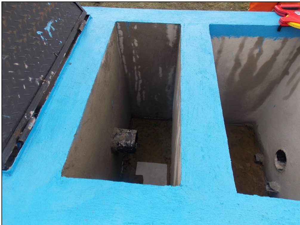
Figura 30: Fotografía de la tubería de descarga instalada en la qocha Estanco Chico (Pas1-2019-Q2)
