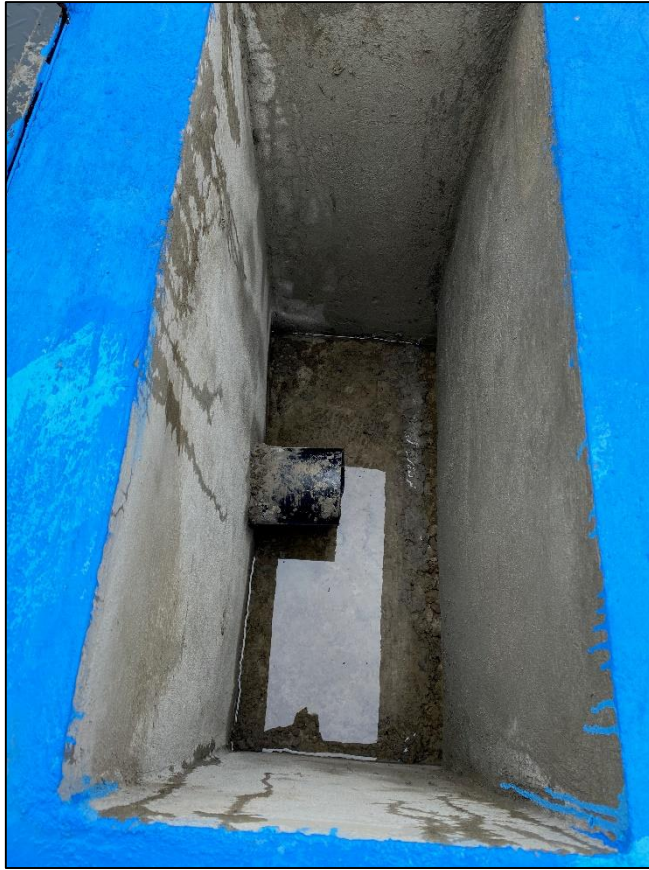
Figura 22: Fotografía de la tubería de descarga instalada en la gocha Los Andes (Pas1-2019-Q1)
