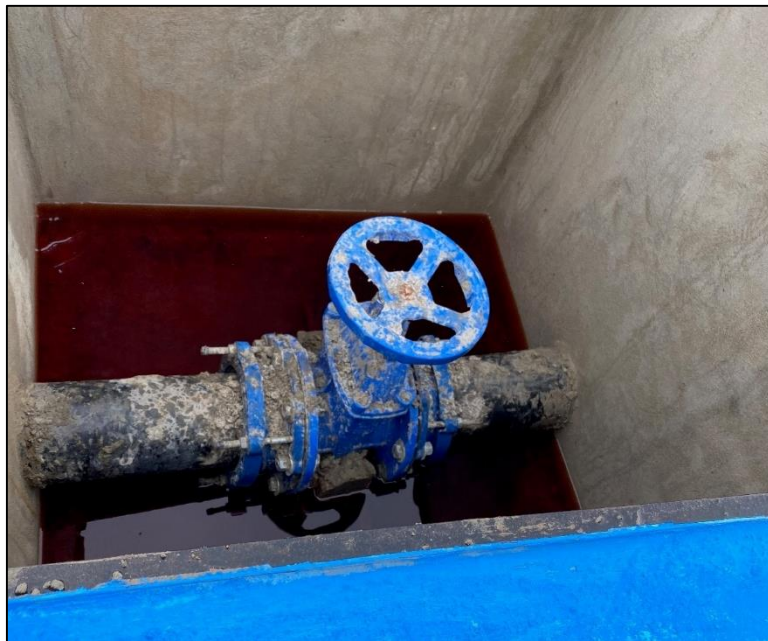
Figura 21: Fotografía de la válvula instalada en la qocha Los Andes (Pas1-2019-Q1)
