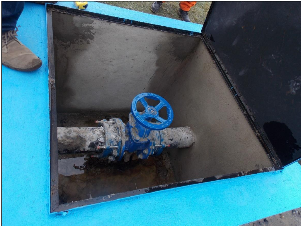
Figura 29: Fotografía de la válvula instalada en la qocha Estanco Chico (Pas1-2019-Q2)
