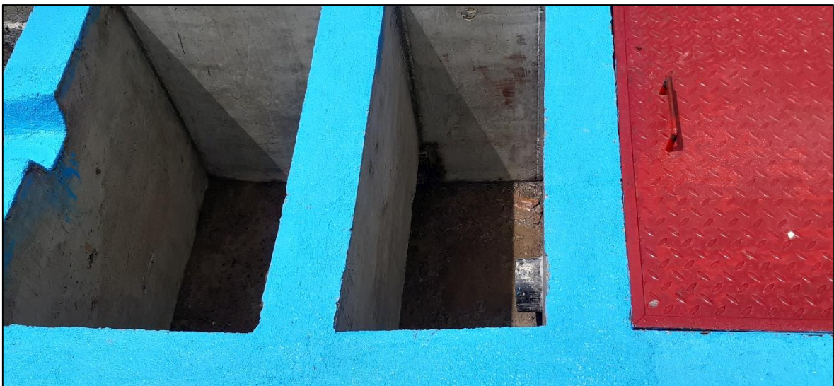
Figura 63: Fotografía de la tubería de descarga instalada en la qocha Sagra Rumi (Pas1-2019-Q6)
