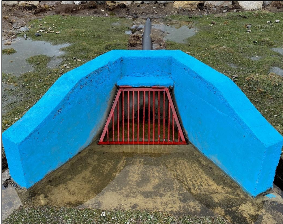
Figura 52: Fotografía de la estructura de la toma (captación) de la qocha Ocshagoto (Pas1-2019-Q5)
