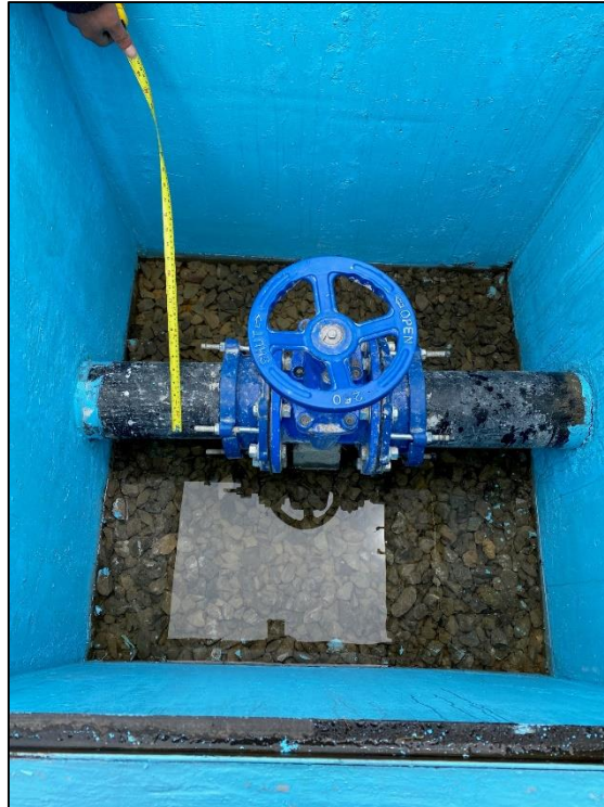
Figura 37: Fotografía de la válvula instalada en la qocha Llamacocha (Pas1-2019-Q3)
