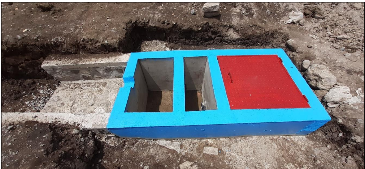
Figura 61: Fotografía de la estructura de la descarga (caja de válvulas) de la qocha Sagra Rumi (Pas1-2019-Q6)
