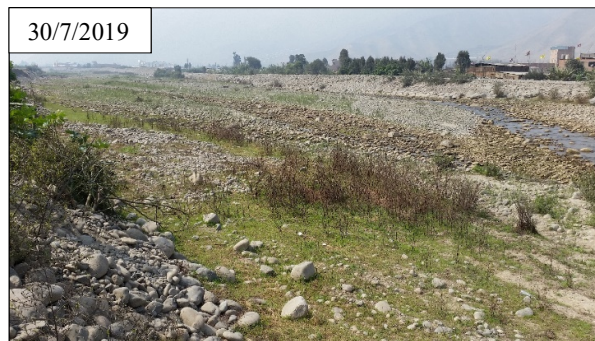
Foto 12 topografía del cauce después del tránsito de la avenida en la progresiva km 0+820
