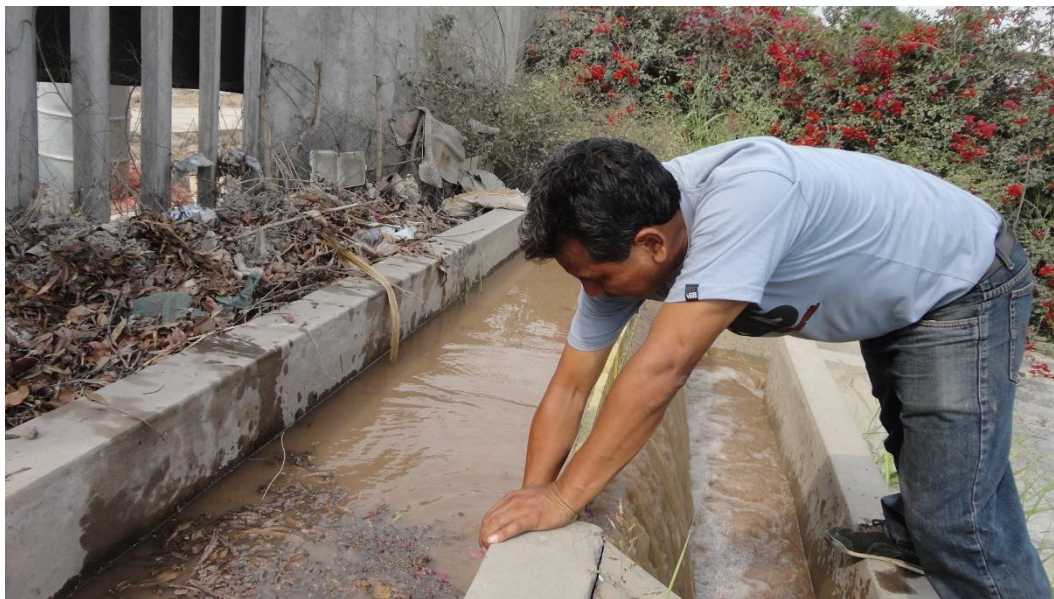
Figura 45: Limpieza manual de la rejilla del canal
