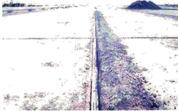
Foto N° 6: Red de tuberías
