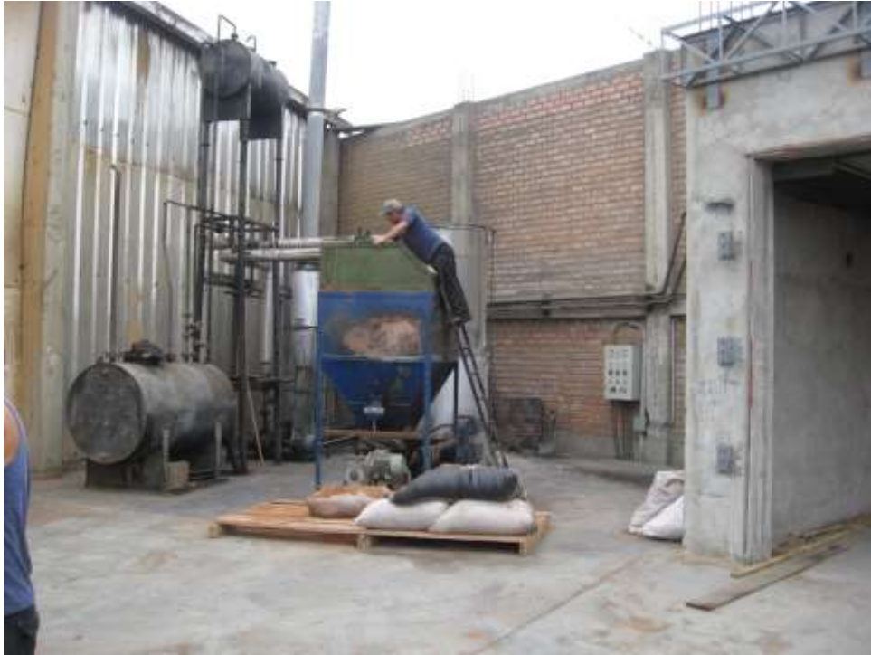
Figura 11: Alimentación del caldero
