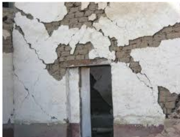
Figura. 8 Grietas producidas ante la simulación sísmica. Fuente: Blondet (2004).
