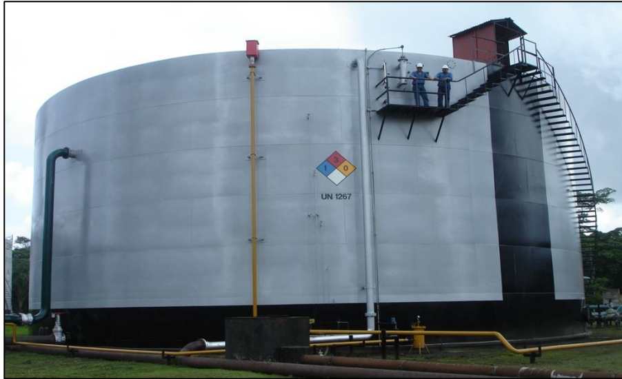
FOTO N° 5: Tanques de almacenamiento de petróleo
